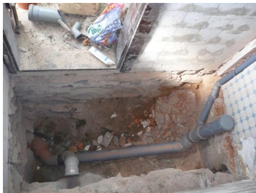
Vedení pod trůnem
